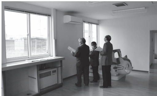
施設内に設置されたエアコン
