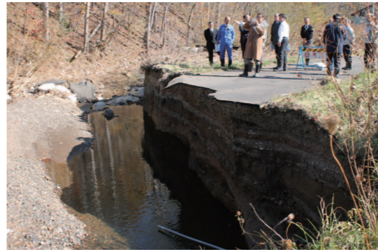
台風による河川の氾濫で被害に遭った道路(知来)
